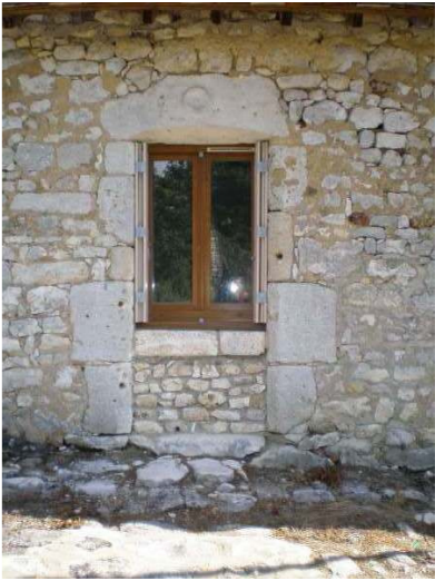
APRES Type de transformation à éviter
