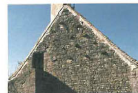
La Boudinière, Pouligny-Saint-Pierre Il arrive que les parpaings dépassent du nu du mur, notamment sur les pignons de certains bâtiments.
