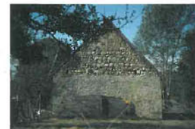
Le ciment est utilisé pour toutes sortes de bricolages en milieu rural. Il n'est pas rare que les restes d'une gâche de ciment soient étalés sur un bas de mur pour "tassainir". Ces réparations, catastrophiques sur le plan visuel et très nuisibles à la santé des murs, sont de plus difficiles à éliminer sans dégrader la pierre.
