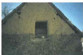
Les ouvertures sont inscrites dans des cadres bois ou, pour les plus petites ouvertures des bâtiments annexes, directement taillées dans la bauge.
