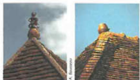
Dans quelques communes riveraines de la Creuse ou plus au sud, on observe de nombreux arêtières constitués d'une largeur de tuiles plates, scellées à plat en recouvrement.
